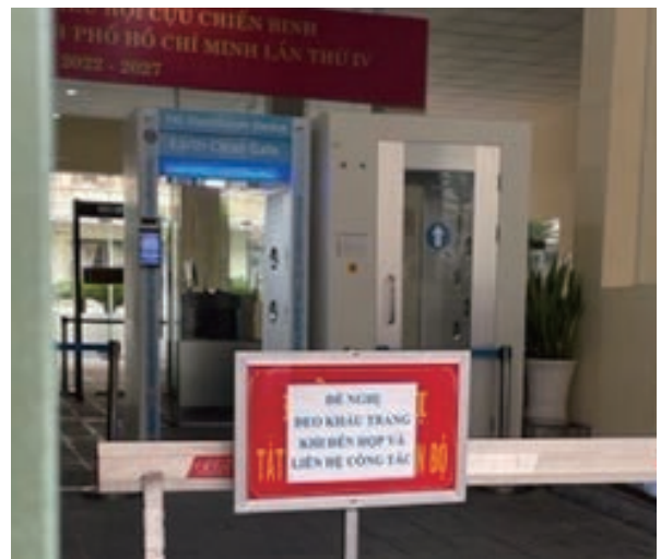
庁舎建屋内入口に設置された ATV 製エアシャワー
