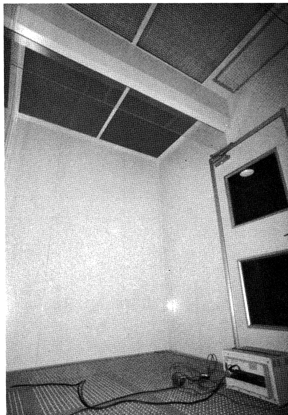
クリーントネル内部
