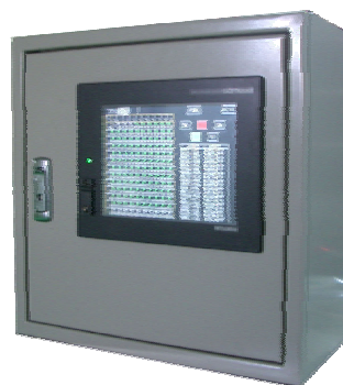
集中制御盤画面部
